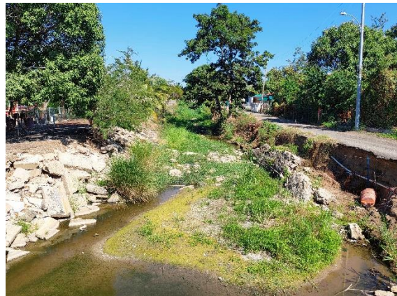
Foto 8 – Vista en dirección este del cauce de la Quebrada Sin Nombre a su paso por la comunidad El Coquí . Nótense la precaria condición del canal.
