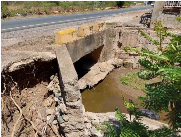
Foto 11 – Vista del cauce de la quebrada a su salida del tramo bajo la PR-3 . Nótese los entorpecimientos de la estructura al libre fluir de las aguas.
