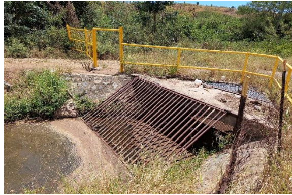
Foto 6 – Detalle de una reja de retención de escombros en el Canal Guamaní , Control hidráulico responsable de retroflujos.
